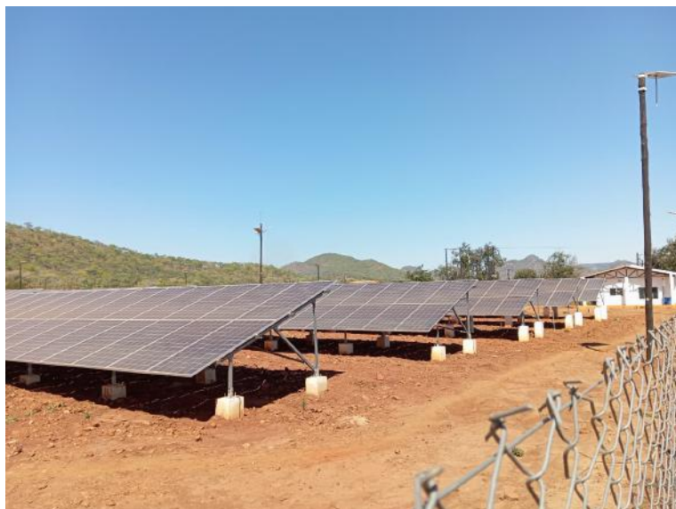
Figura 4-15: Sistema fotovoltaico da sede da localidade de Mualadzi
