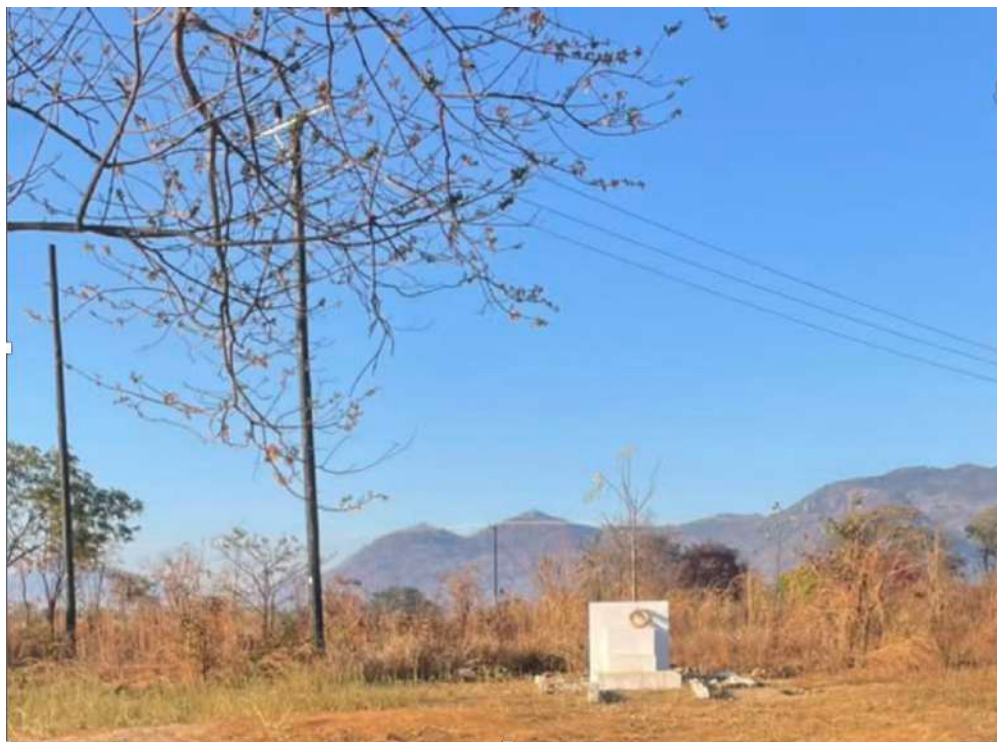
Figura 6-19: Linha de Rede Eléctrica de Média Tensão
